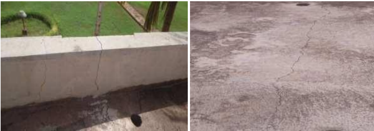
Photo 6 : Fissures sur les murs des acrotères et sur la toiture
