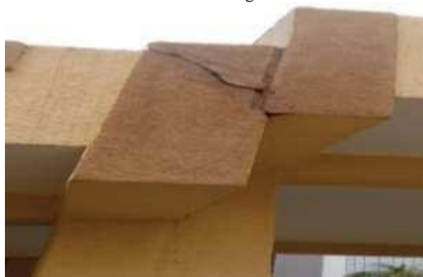
Photo 13 : Joint de dilatation dégradé
