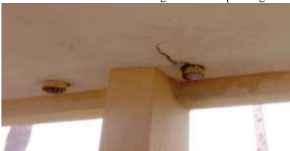
Photo 8 : Descentes d'eau dirigées dans le parking
