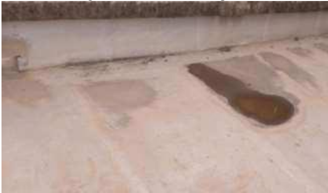
Photo 14 : Stagnation d'eau sur toiture par endroit
