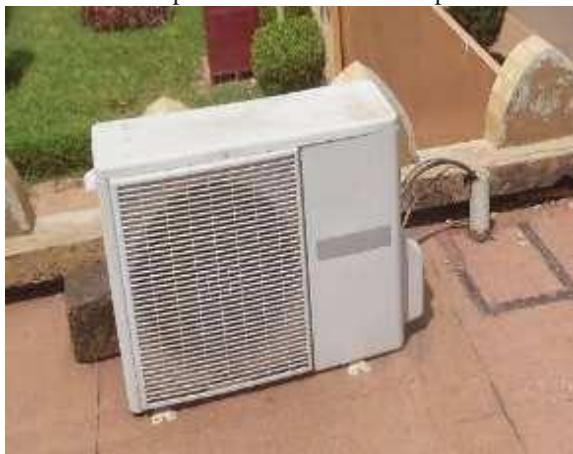
Photo 16 : Compresseur de climatiseur split sans socle
