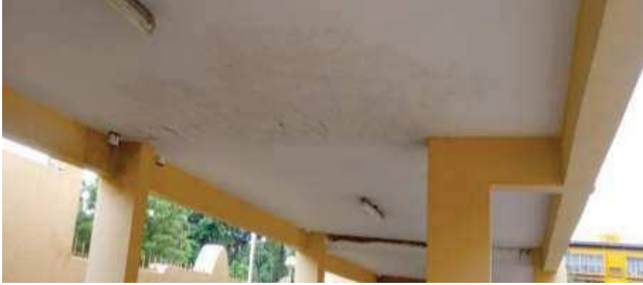
Photo 36 : Descentes d'eau dirigées dans le parking–Fissures
