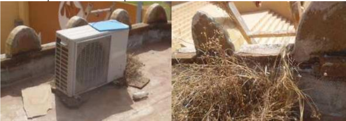
Photo 3 : Herbes sur toiture
