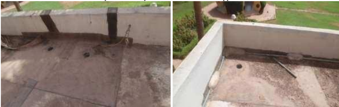
Photo 7 : Descente d'eau sans crapaudines/ Tuyaux et fils d'électricité apparents
