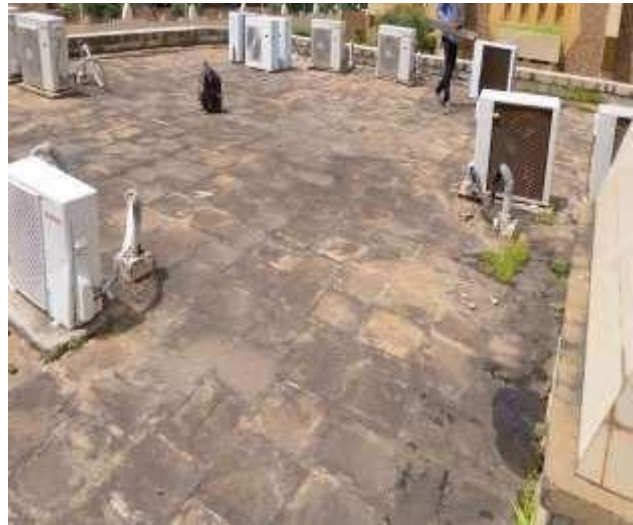
Photo 22 : Présence d'herbes sur la dalle et stagnation
