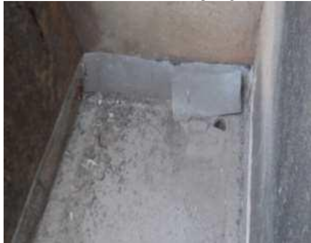
Photo 29 : Relevé étanchéité non protégé
