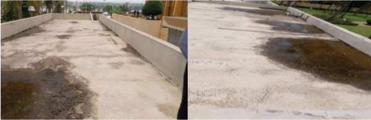
Photo 5 : Manque de forme de pente, couronnements/becquets périphériques et stagnation d'eau sur toiture
