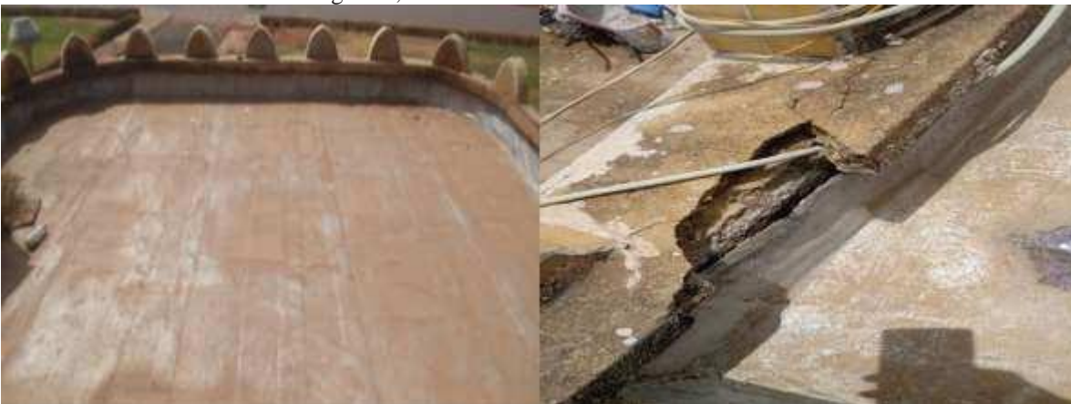
Photo 4 : Etanchéité existante dégradée, relevé décollé
