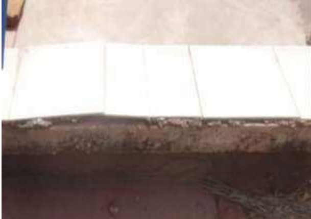
Photo 18 : Carrelage sur couronnement en cours de dégradation
