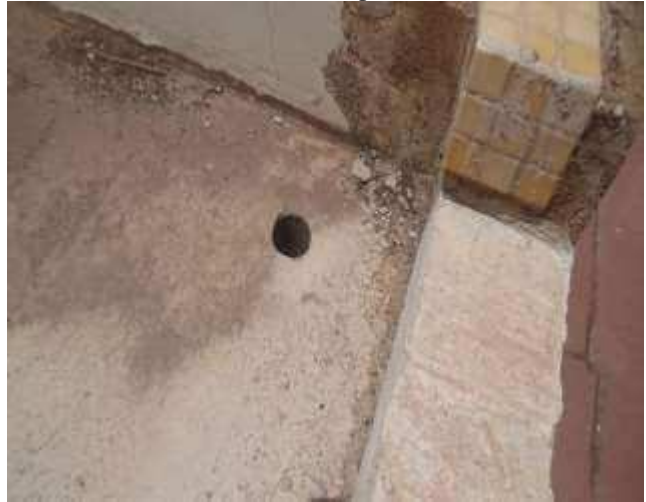
Photo 33 : Descente d'eau sans crapaudines
