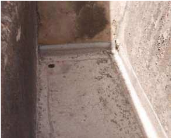
Photo 28 : Pas de crapaudines sur descentes d'eau
