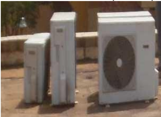
Photo 24 : Pas de socle sous certains compresseurs de split
