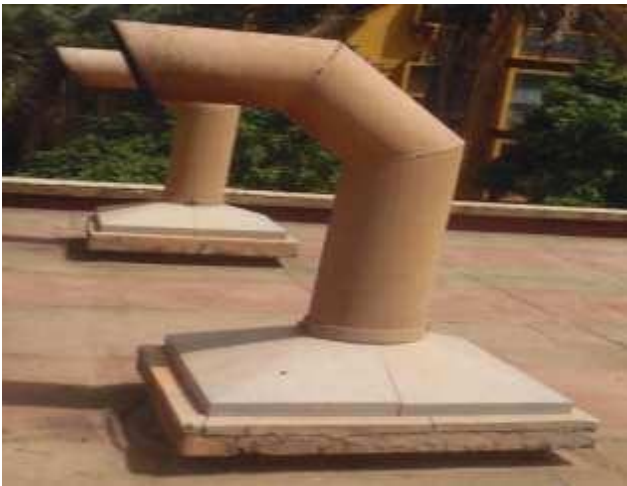
Photo 19 : Chape sur couronnement fissures
