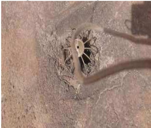
Photo 23 : Crapaudines existantes dégradées
