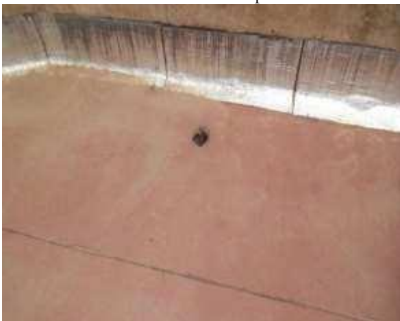
Photo 34 : Relevé d'étanchéité sans protection
