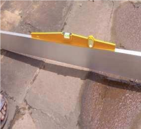
Photo 21 : Stagnation d'eau sur toiture (Présence de creux sur la forme de pente)
