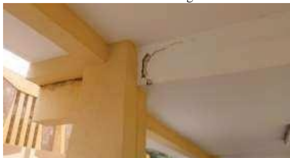
Photo 9 : Joint de dilatation dégradé
