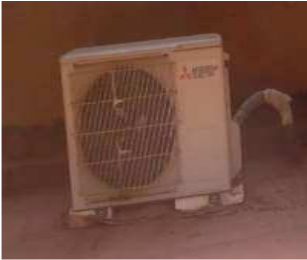
Photo 26 : Pas de socle sous certains moteurs clim split
