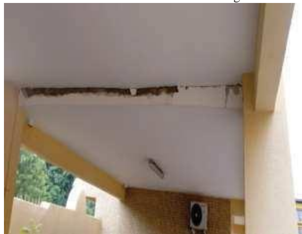
Photo 35 : Joint de dilatation dégradé
