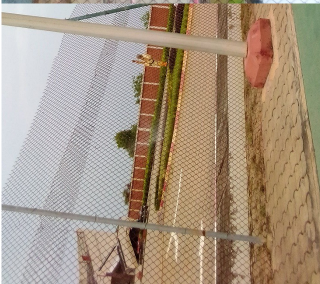
IMAGE 5 : VUE LOINTAINE SUR UNE PORTION DE GRILLAGE ROUILLE.
