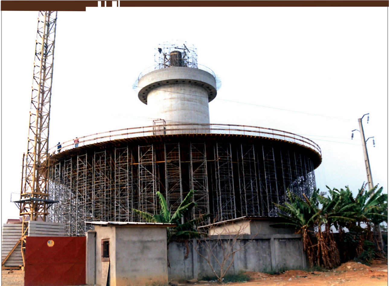
Construction d'un château d'eau d'une capacité de 5000 m 3 à Abidjan (Côte d'Ivoire).
